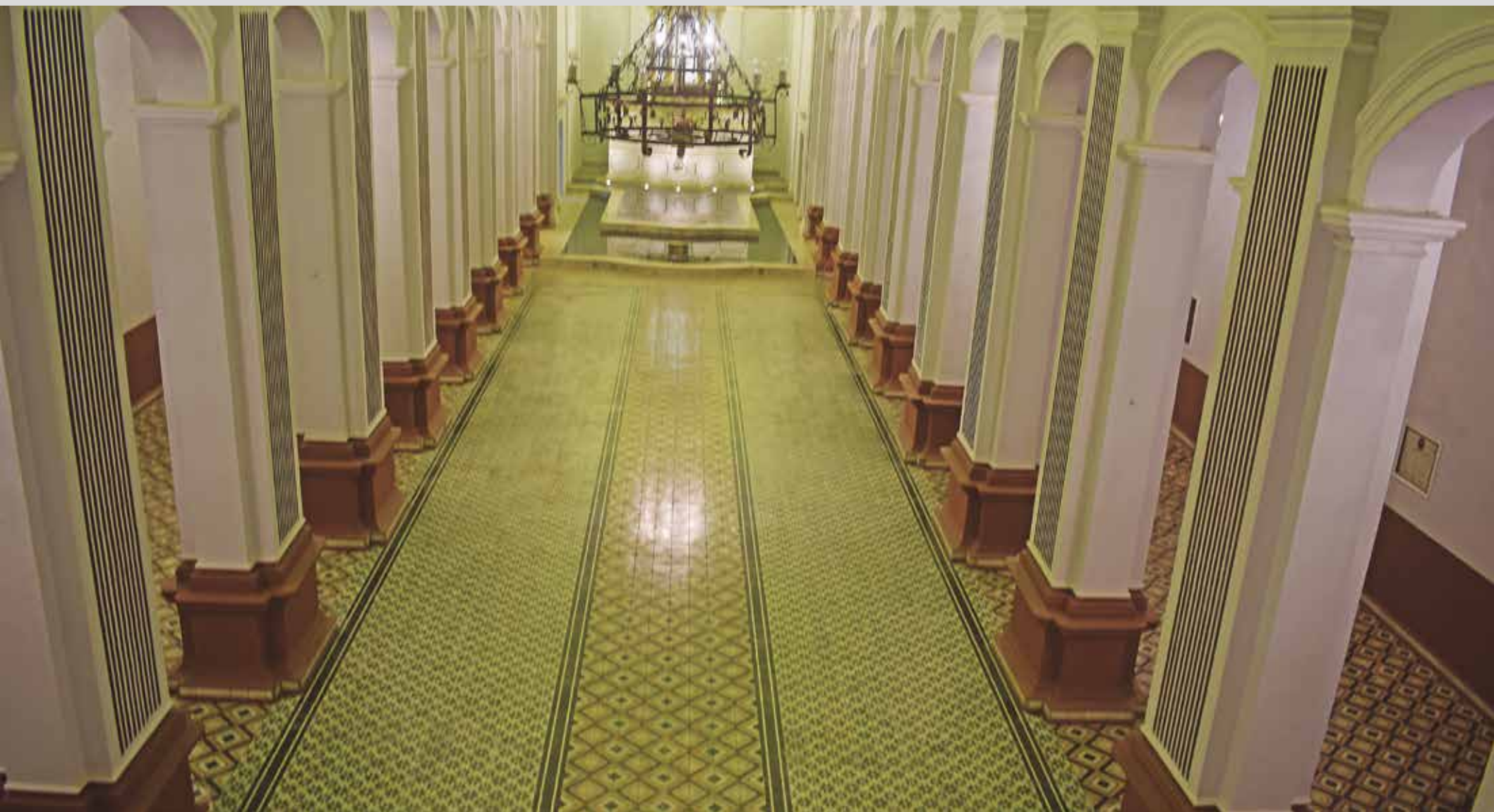
Lámina No. L-63.- Pisos de mosaico en nave central y naves laterales.
